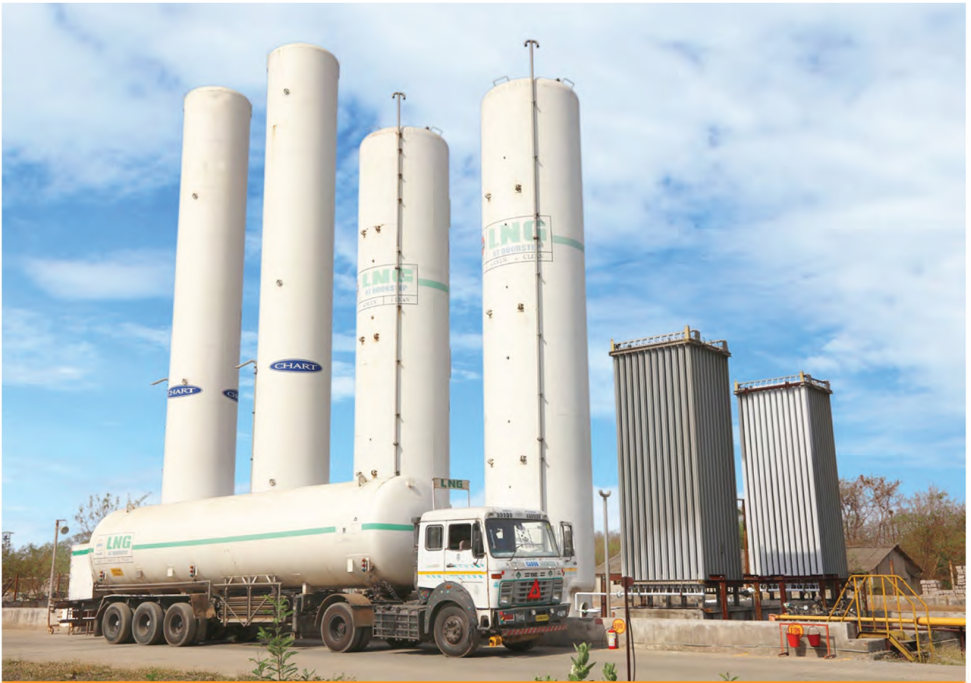
LNG Terminal at Nashik
